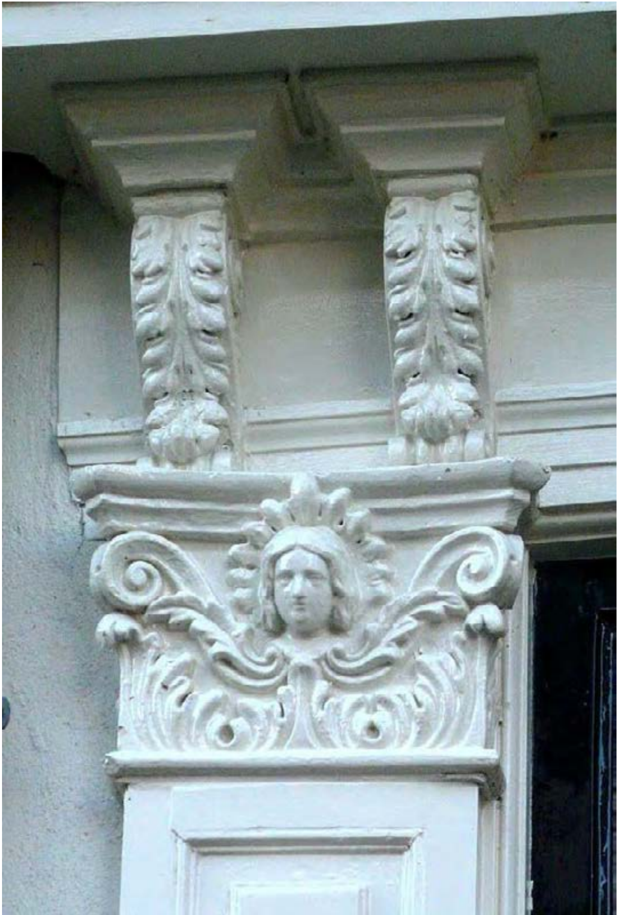
Op bovenstaande foto de linker van de pilasters. Boven de Groene Vrouw zijn de consoles van de gevellijst te zien, geheel bedekt met bladeren.
